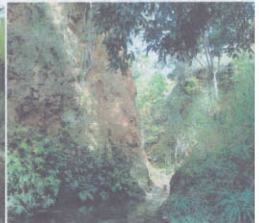
Figura 4 – Processo Erosivo causado pelo escoamento da água
